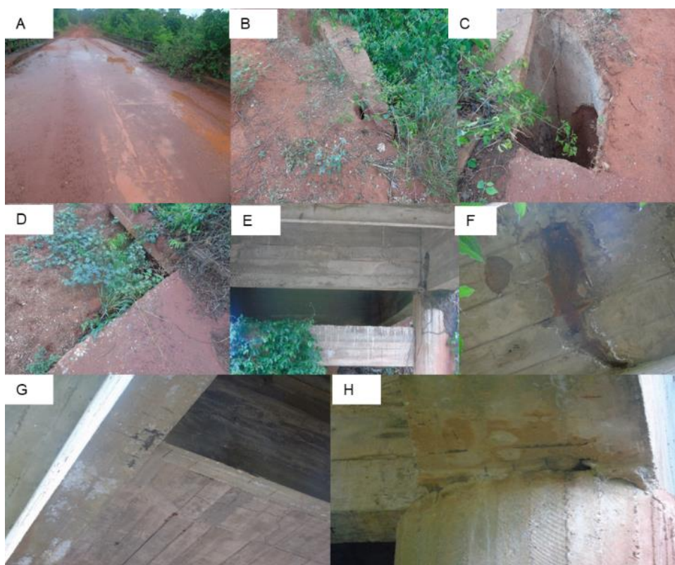
Figura 2. (A) terra e vegetação sobre a ponte, (B) erosão na parte direita da ponte, (C) erosão na parte esquerda da ponte, (D) erosão no outro lado na parte direita da cabeceira da ponte, (E) exsudação na viga transversal, (F) dreno entupido, (G) viga com armadura exposta com oxidação, (H) junção viga pilar com armadura exposta com oxidação.
