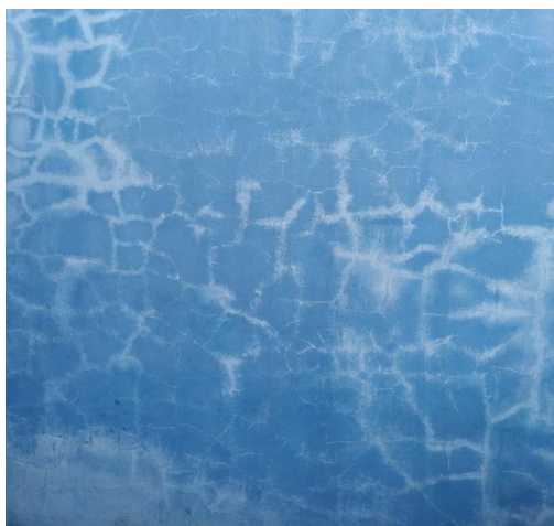
Figura 7. Eflorescência na parede externa
