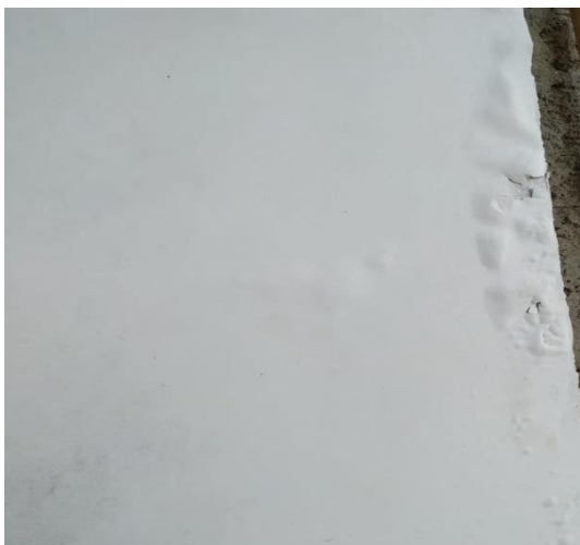
Figura 4. Mofo, empolamento e descascamento da pintura.
