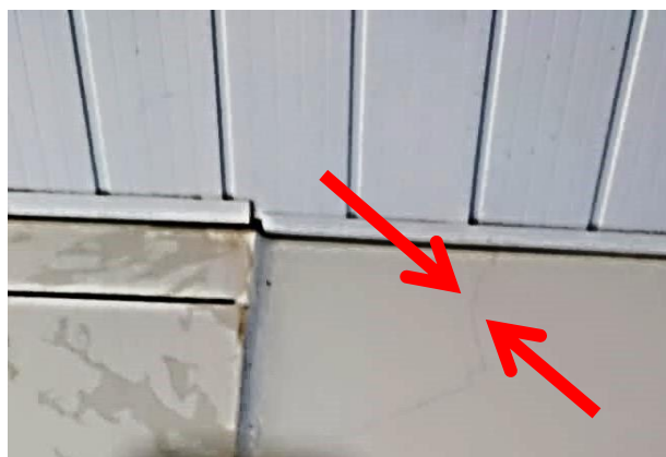
Figura 8. Demonstração de patologia encontrada em uma das residências: fissura, indicada pelas setas vermelhas.
