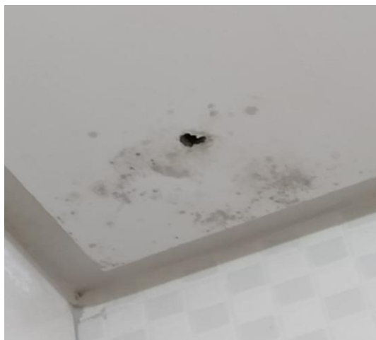
Figura 5. Mofo e goteira no teto do banheiro.
