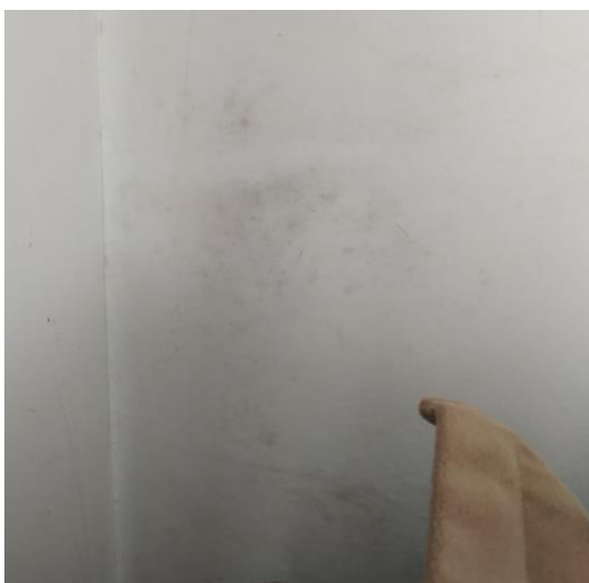
Figura 2. Exemplo de patologia encontrada nas residências: mancha provocada por umidade em uma das residências.
