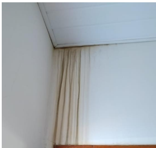
Figura 9. Infiltração no teto de PVC.
