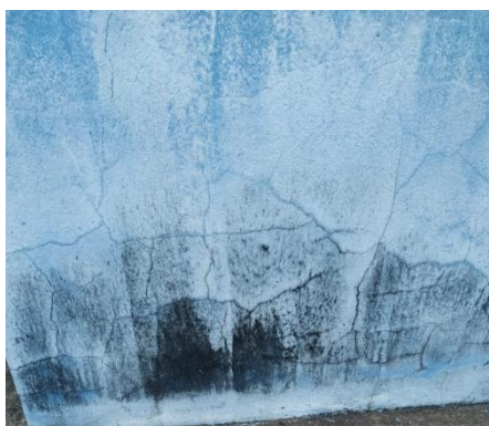
Figura 6. Mofo e fissuras na parede externa.
